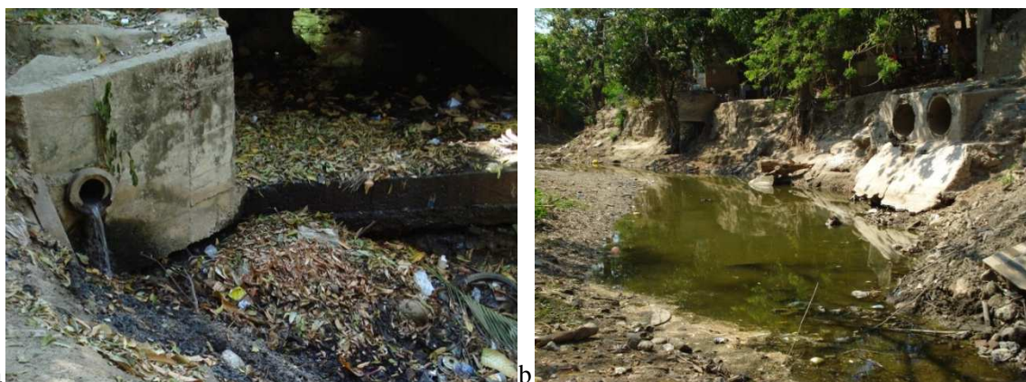
Figura 4.12. Manejo de aguas residuales y pluviales municipales el Santa Marta - zona costera del Magdalena.
